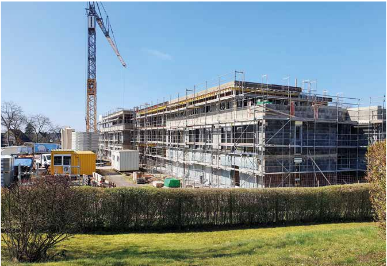
Blick auf den beeindruckenden Baukörper, der noch dieses Jahr fertiggestellt werden soll.
